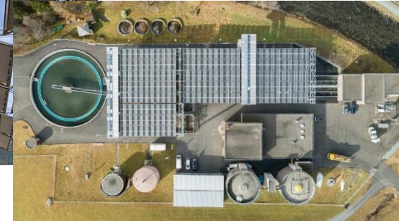
Beispiel: solares Faltdach für die Kläranlage Davos
