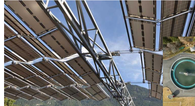
Beispiel: Faltdach der Kläranlage ARA Chur
